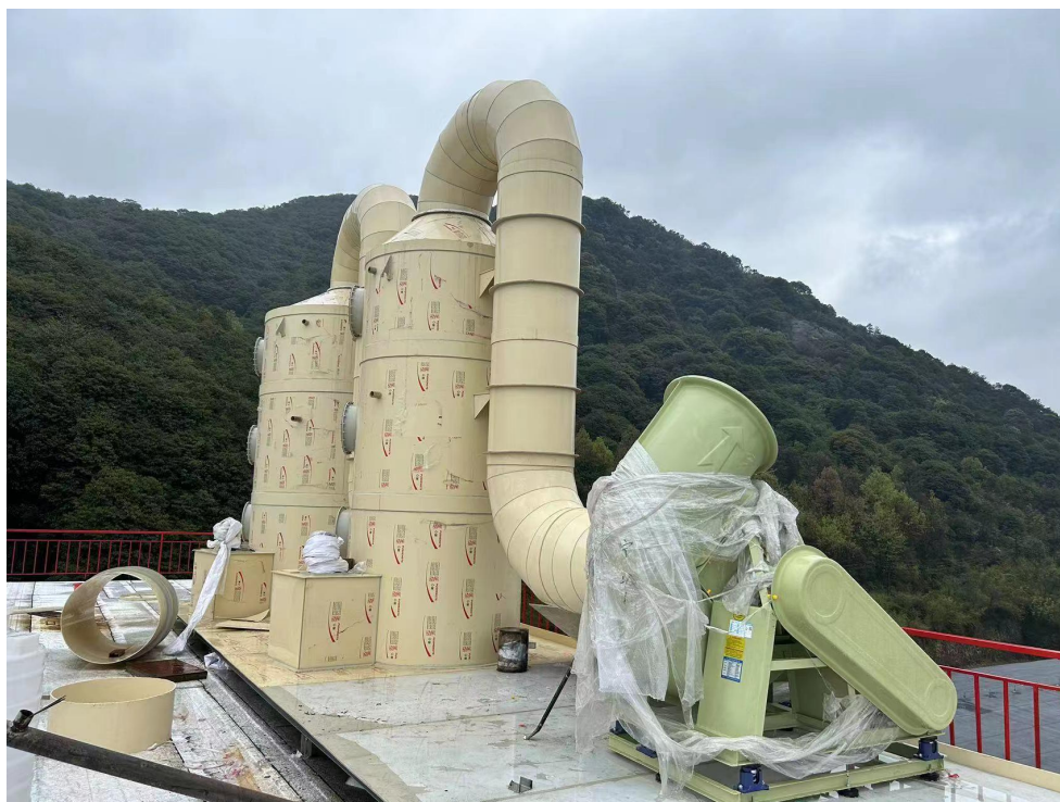
废气处理设施
