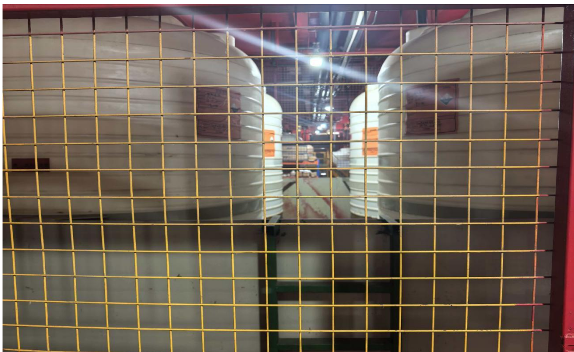
图 4.2-2 废蚀刻液储罐现场图
