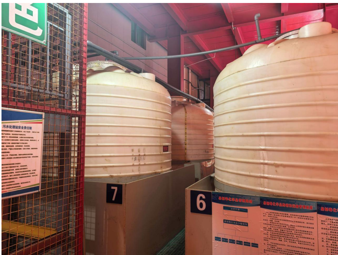
图 4.2-1 储罐区及托盘现场图
